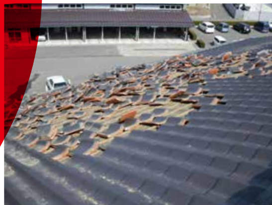
▼地震によって壊れた役場の屋根瓦
